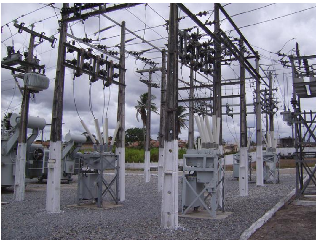
Subestação Itabaianinha, localizada no município de Itabaianinha, em operação desde
