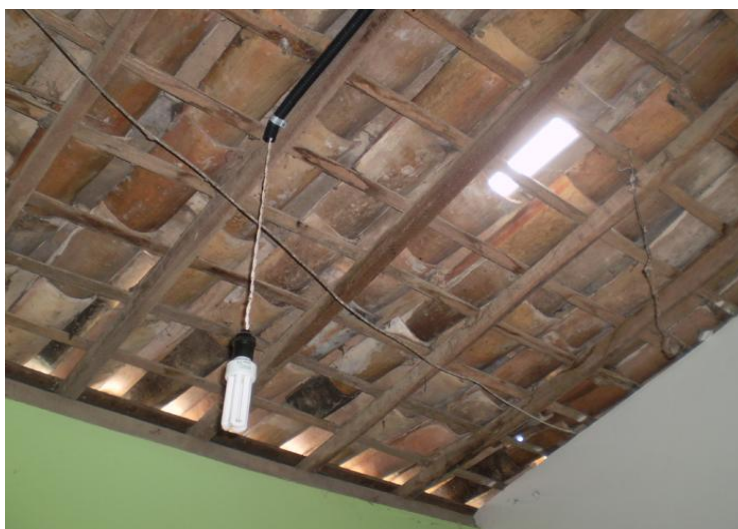
Telha Transparente, para se obter economia de energia elétrica
